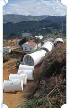
Clarificadores Y Filtros, Nueva Ptap Automatizada Para Instalar En Sector Patio Bonito, Vereda San Ignacio
